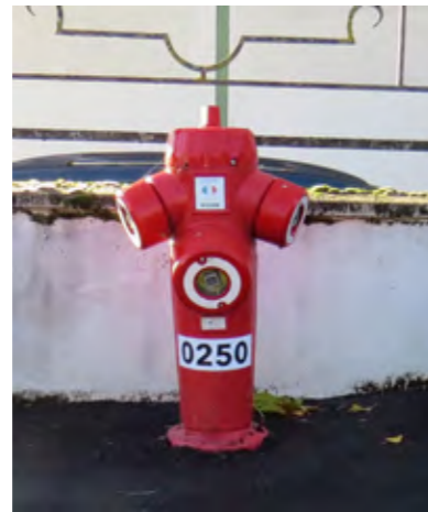
POTEAU INCENDIE RUE DE LA MINOTERIE
